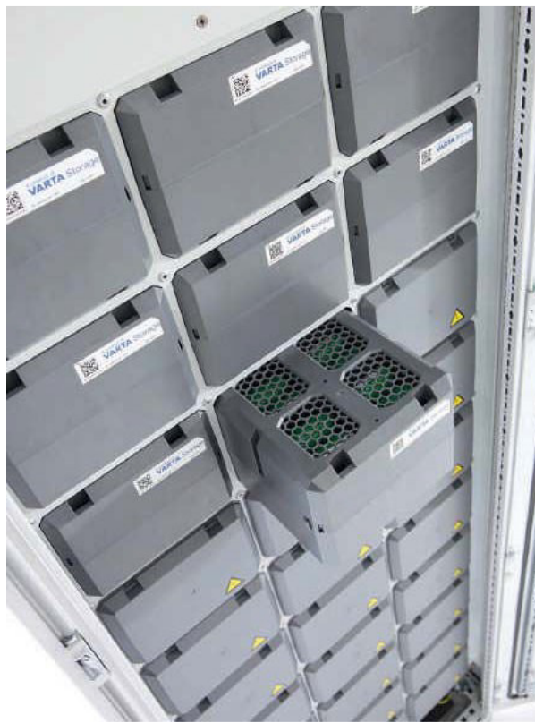
Ein einzelnes Batteriemodul des Energiespeichers Engion hat eine Kapazität von 0,46 kWh.
