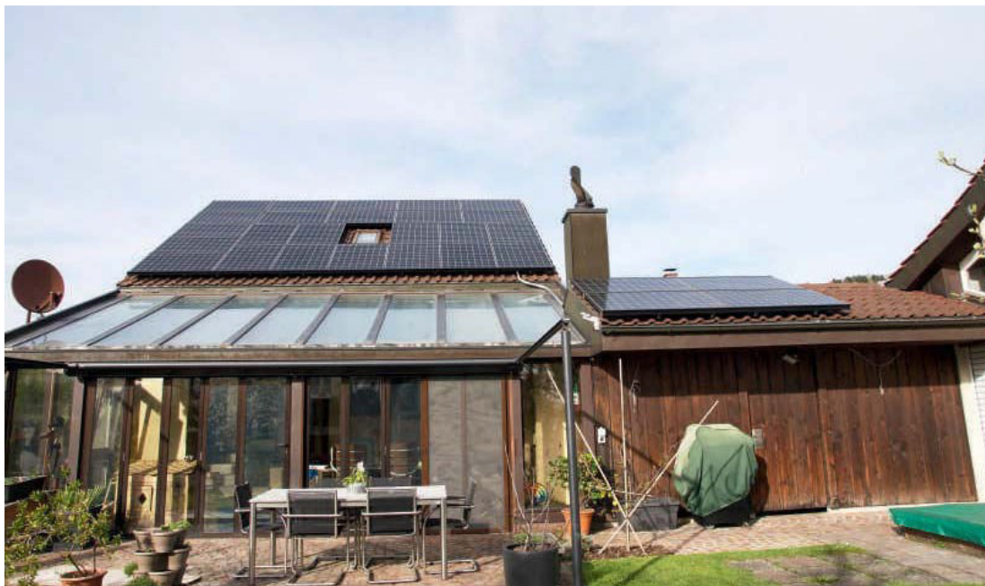
Die Photovoltaikanlage des durch Thomas Merki und seiner Familie bewohnten Eigenheims verfügt über eine installierte Leistung von 9,7 kWp.
